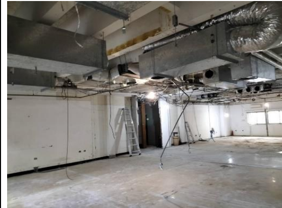
送風機、風管現況
