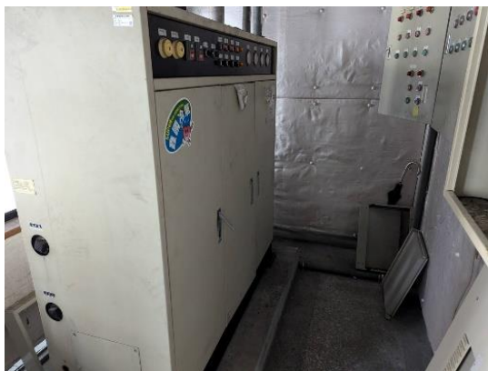
老舊冰水主機
